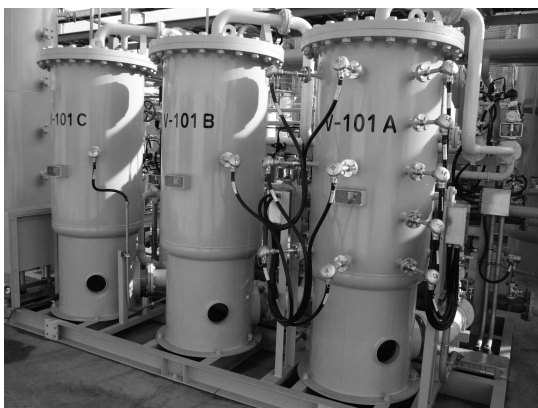
写真3 「ASCOA-3」 吸着塔外観
